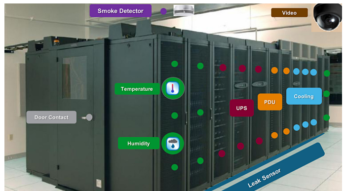
Überwachung und Verwaltung der Sensoren im RZ.
